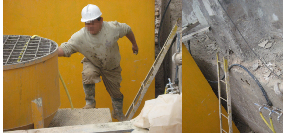
Acceso inadecuado, escaleras deficientes y huecos en las plataformas
