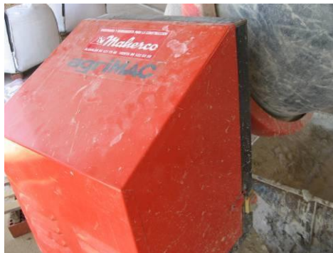
Nueva ubicación de los controles
