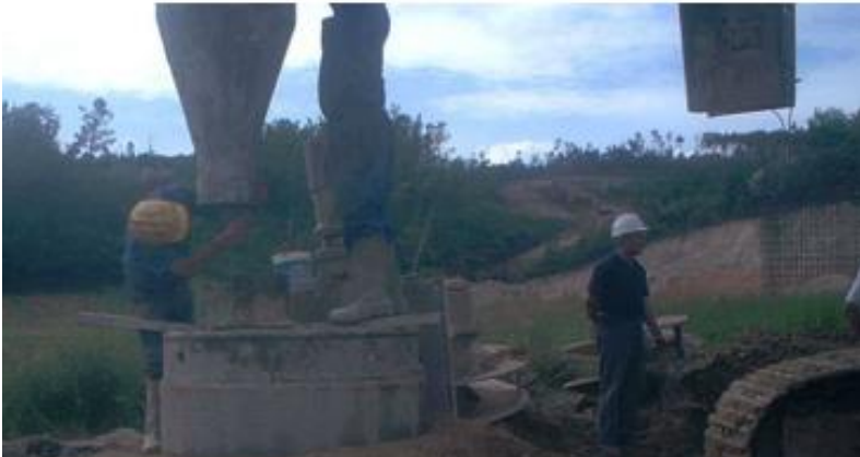
Imagen 22. Riesgo de caída al interior del pilote
