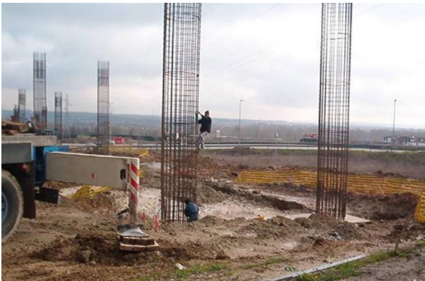
Imagen 26. Acto inseguro. Trepando por la armadura.
