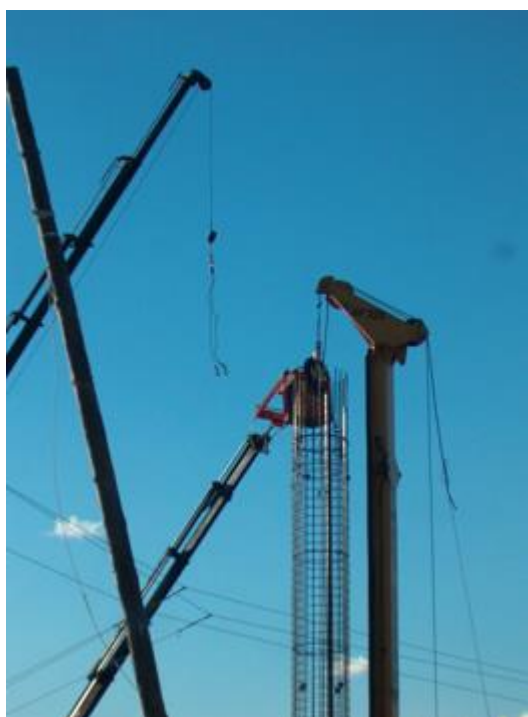
Imagen 19. Interferencia con líneas eléctricas
