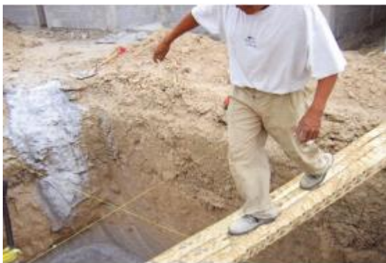
Imagen 13. Acto inseguro: tablón de paso entre ambos extremos de la zapata. Se observan las cuerdas de nivelación
