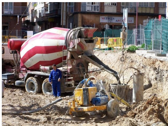
Imagen 39. Hormigonado. Malas prácticas en general.
