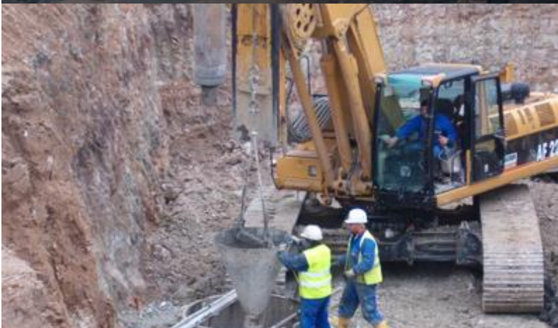
Imagen 23. Riesgo de caída al interior del pilote. Altura de la camisa metálica insuficiente
