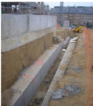
Imagen 34. Señalización con stopper del riesgo de caída a distinto nivel en murete guía
