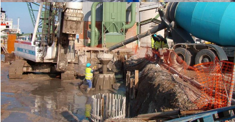
Imagen 24. Mal estado general de la plataforma de trabajo, vallado, hormigonado, etc.
