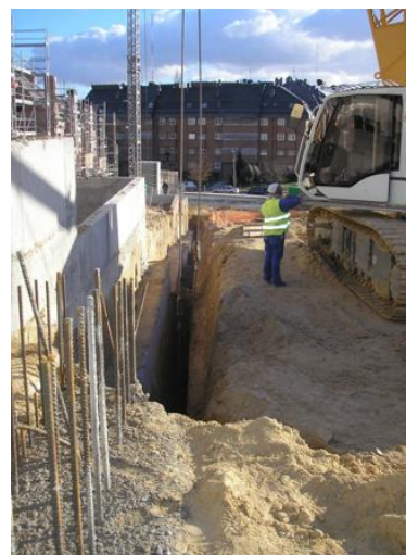
Imagen 37. Acceso a borde de excavación de pantalla sin protección
