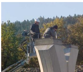
Imagen 1: replanteo de estructura, con riesgo de caída en altura
