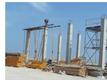
Imagen 17. Diseño clase B. Cabe destacar la falta de seguridad del trabajador. Tanto en el acceso como en la plataforma de trabajo.
