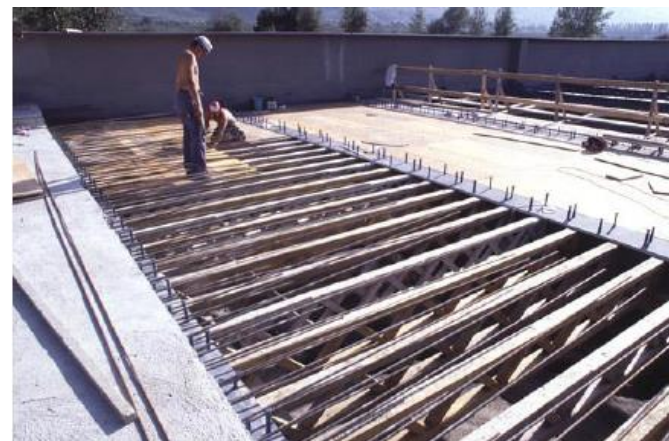
Imagen 39: Hormigonado y encofrado de la losa inferior. Los huecos entre arriostramientos de vigas deben ser cubiertos mediante tablonos. Existe alto riesgo de caída de altura. Se deben ir asegurando los accesos por tramos. Mientras el acceso se realiza con línea de vida. Fuente: Universidad de Caminos, Canales y Puertos. Curso de puentes II.
