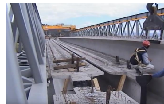
Imagen 48. Riesgos de caída entre las vigas
