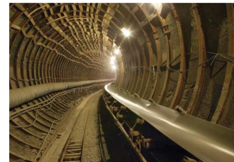
Imagen 13. Aspecto de túnel con el sistema de extracción mediante cinta transportadora
