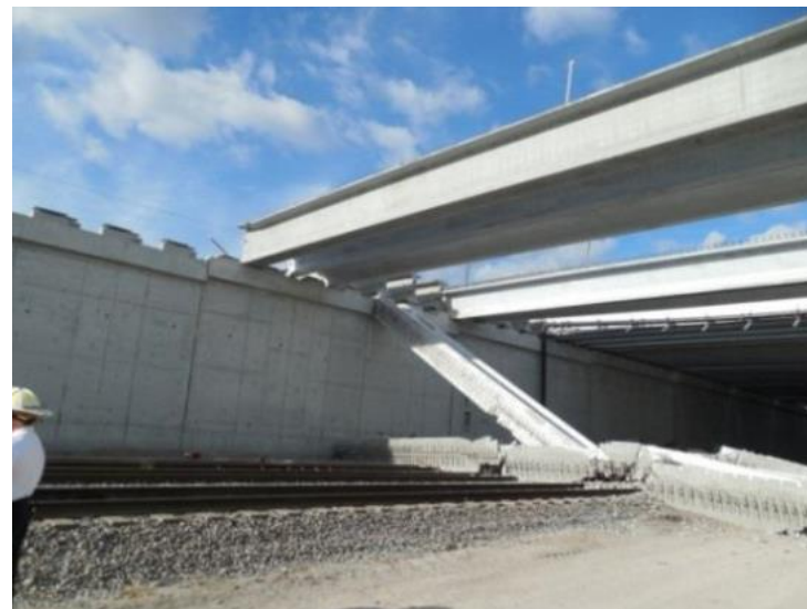
Imagen 31: Caída de vigas prefabricadas por acumulación de errores, en el diseño de los refuerzos, arriostramientos, empujes laterales no estudiados, etc. Fuente: Investigación de accidente. Departamento de Seguridad y Salud Laboral de USA. Abril 2014.
