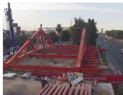
Imagen 30. Trabajos en estructura sobre suelo previo a montaje en tablero. Se necesitan los medios adecuados para el acceso y permanencia de los trabajadores sobre estos puntos. En este caso, por falta de espacio no se dispusieron adecuadamente. Fuente: https://www.youtube.com/watch?v=Diy9885bcsA
