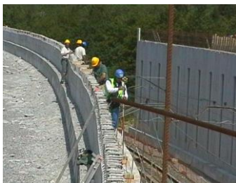
Imagen 3. Riesgo de caída en altura en replanteo de estructura
