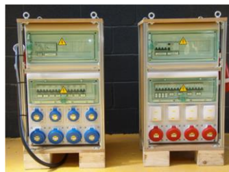
Cuadro eléctrico auxiliar.
