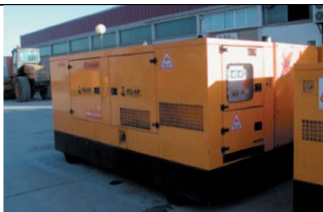
Imagen 5. Grupo electrógeno. Fuente: FLC
