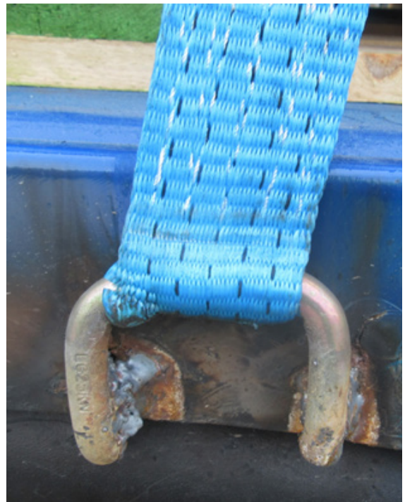
Figura 22 Imagen que muestra un gancho soldado a la estructura del vehículo. Fuente: DEKRA
