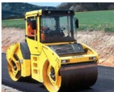
Equipo de trabajo: Compactadora Aceleración m/s^2 : 0.2-1 m/s^2
