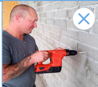
Sin sistema de captación de polvo
